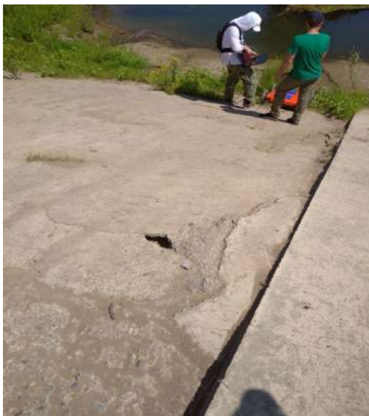
Рисунок 10 – Полость в верхней части бетонного покрытия откоса нижнего бьефа ГТС Figure 10 – Cavity in the upper part of the concrete pavement of the downstream slope of the GTS
